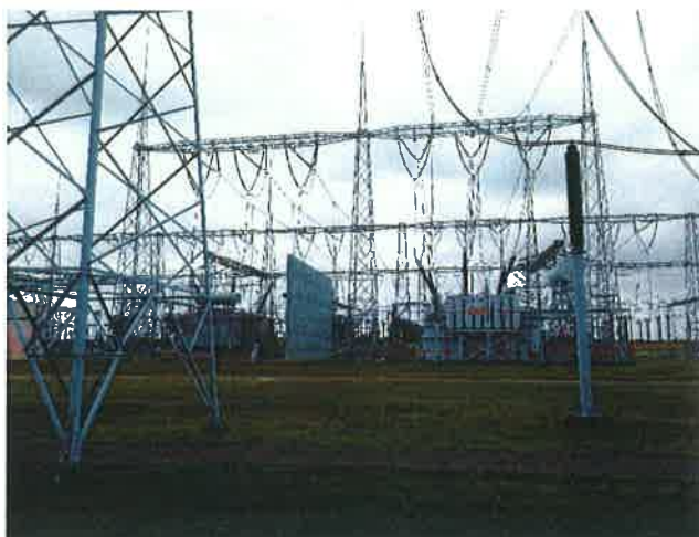
Rysunek nr 4. Widok stacji elektroenergetycznej
