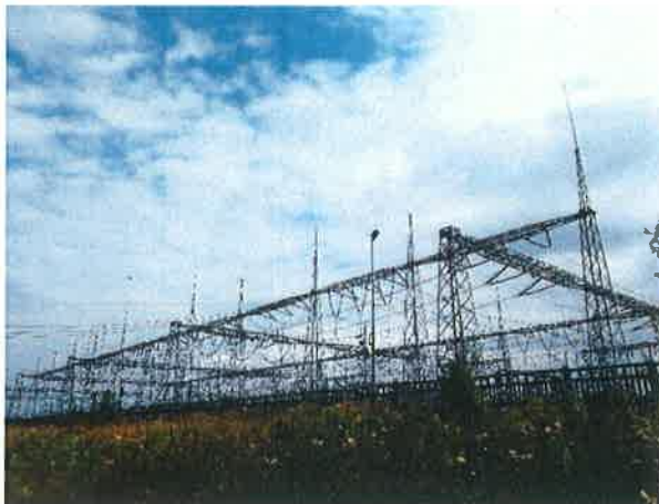
Rysunek nr 1. Widok stacji elektroenergetycznej
