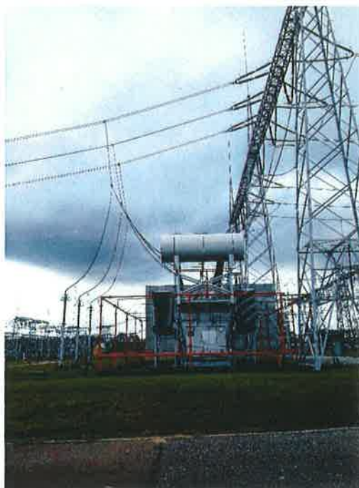
Rysunek nr 5. Widok stacji elektroenergetycznej
