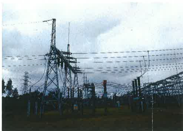
Rysunek nr 2. Widok stacji elektroenergetycznej
