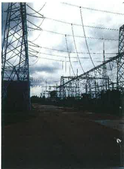
Rysunek nr 3. Widok stacji elektroenergetycznej
